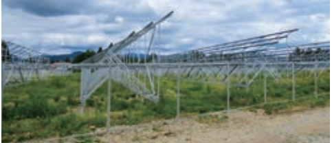
＜施行中＞発電システムの骨組みと、侵入防止柵などを設置。同時に敷地内緑地化のための準備も進めます
